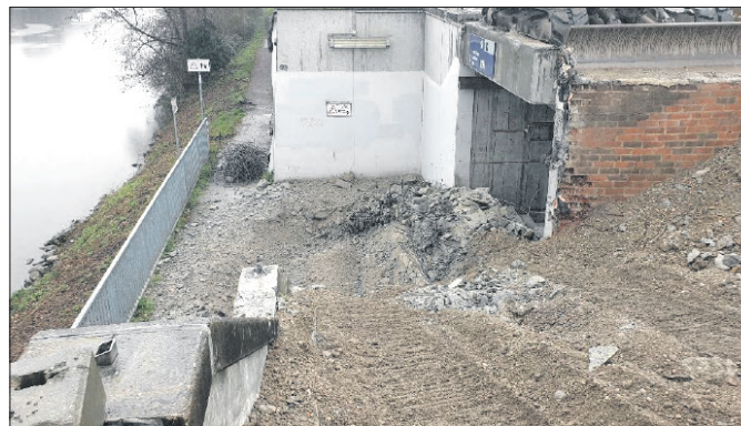
Der Neckaruferpark erstreckt sich künftig zwischen Bahnlinie und Neckar. Ein Teil des Ausgangs der Bahnunterführung musste abgerissen werden. Fotos: Stadt Esslingen
